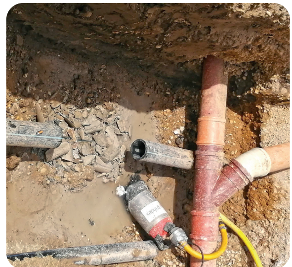
Ablagerungen von Innenputz im Abwasserkanal
