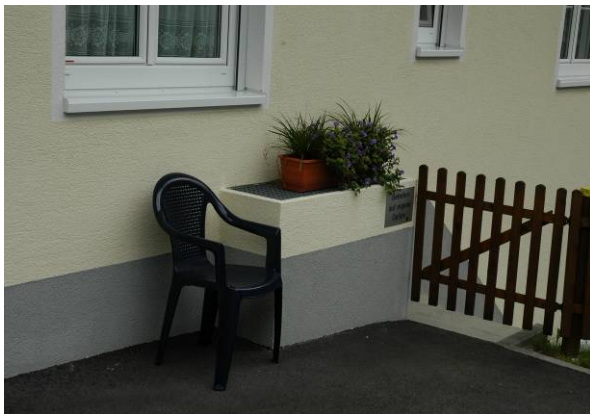
Abb. 5.5: Druckwasserdicht mit der Wand verbundener, nach unten geschlossener Kellerfensterlichtschacht aus Beton, der deutlich über das Hochwasserniveau hochgezogen wurde; aus [9]
