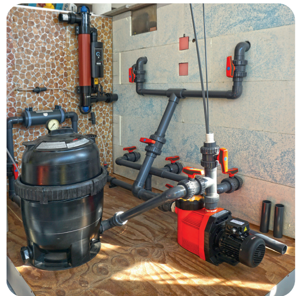
Filter mit Pumpe und Verrohrung
