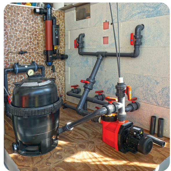
Filter mit Pumpe und Verrohrung
