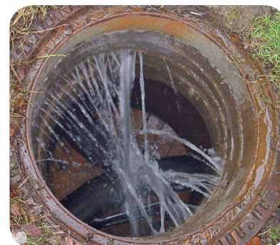
Grundwassereintritt im undichten Kanalschacht.
