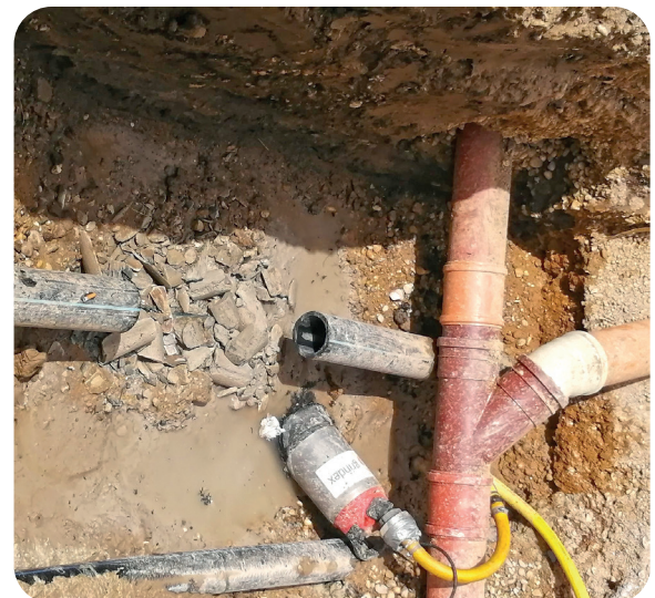
Ablagerungen von Innenputz im Abwasserkanal
