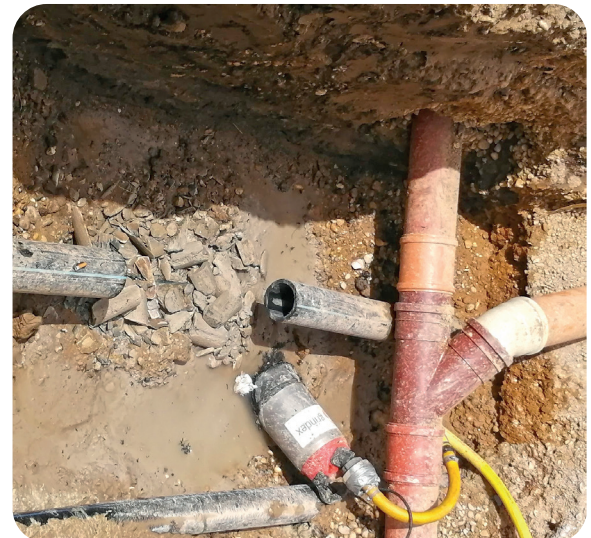
Ablagerungen von Innenputz im Abwasserkanal
