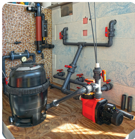
Filter mit Pumpe und Verrohrung
