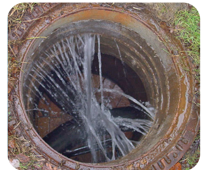
Grundwassereintritt im undichten Kanalschacht.
